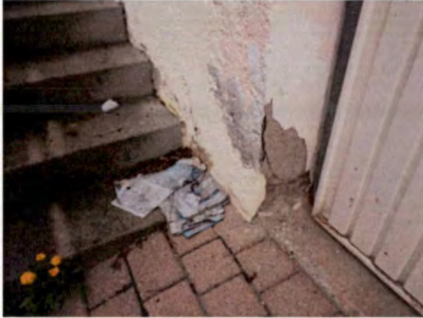
Beschädigung an der Fassade
