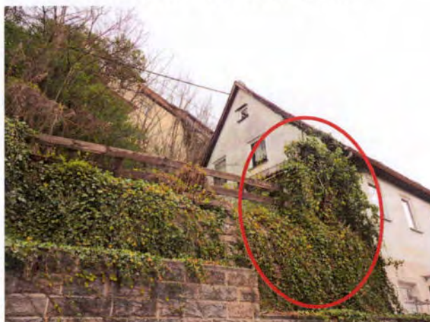
Außenansicht Gebäude und Efeubewuchs
