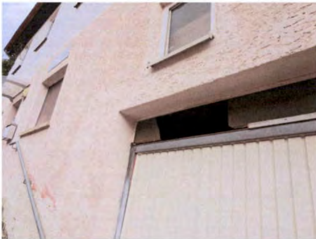
Beschädigtes Tageslichtelement über der Garage
