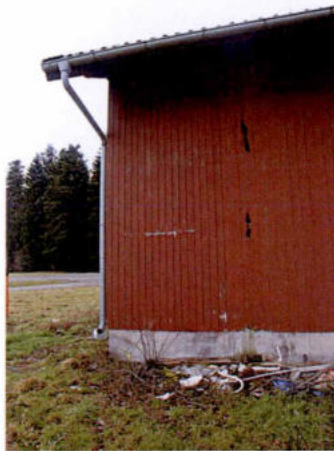
(9) Detail Bauzustand Fassade mit Löchern
