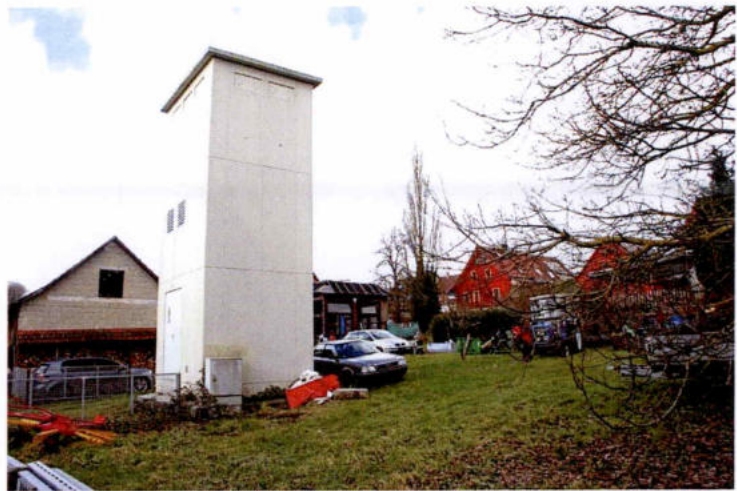
(7) Elektrostromstation auf Nachbargrundstück Flst. Nr. 367
