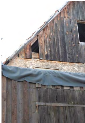
(69) Detail Schuppenanbau, Wasser dringt ein
