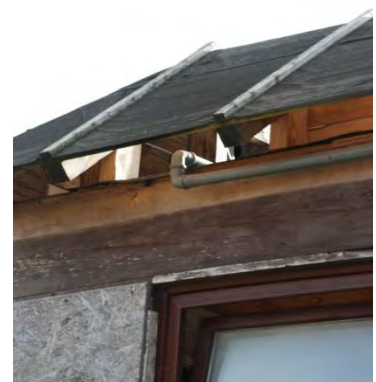
(72) Dito Schuppenanbau provisorisches Dach, Wasser dringt ein
