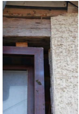
(74) Detail Fassade Fassade ist nicht regen-
