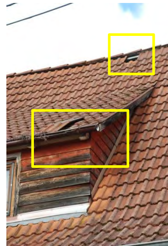
(7) Detail Dach; Dach ist undicht
