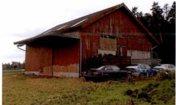
(7) Ansicht Nordost mit Lagergut (nicht mehr zugelassene PKW - Fahrzeuge auf dem Grundstück)
