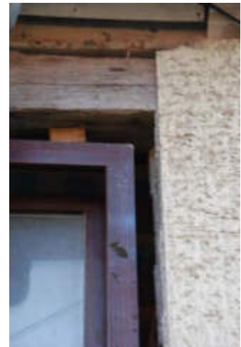
(74) Detail Fassade Fassade ist nicht regen-
