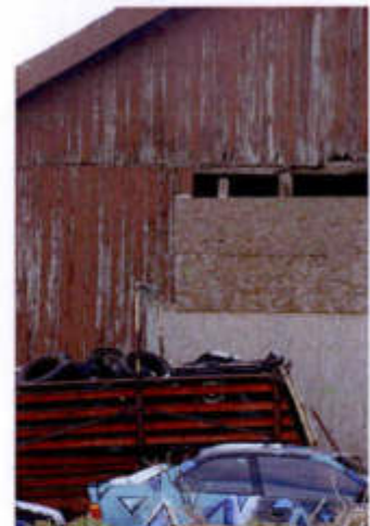
(5) Detail Bauzustand Holzfassade
