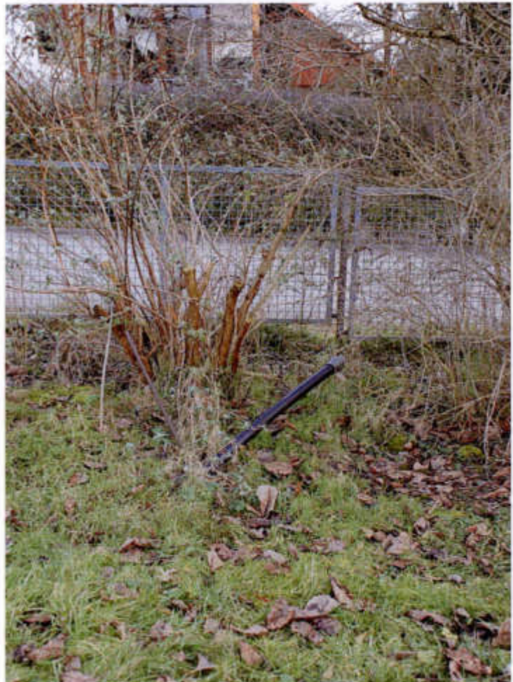
(8) Elektroanschlüsse bereits auf dem Bewertungsgrundstück
