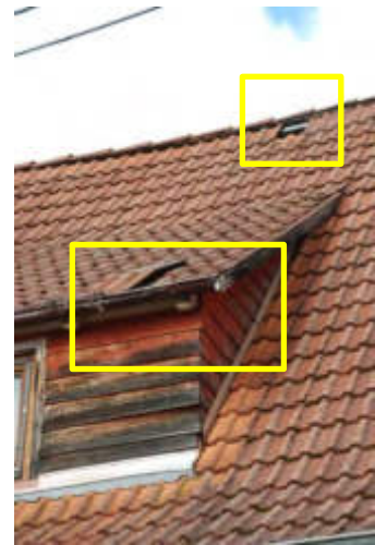
(7) Detail Dach; Dach ist undicht
