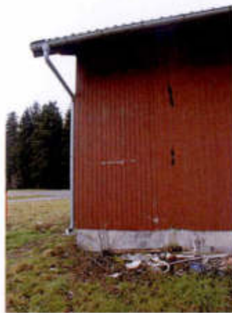
(9) Detail Bauzustand Fassade mit Löchern
