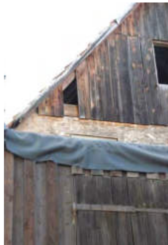
(69) Detail Schuppenanbau, Wasser dringt ein
